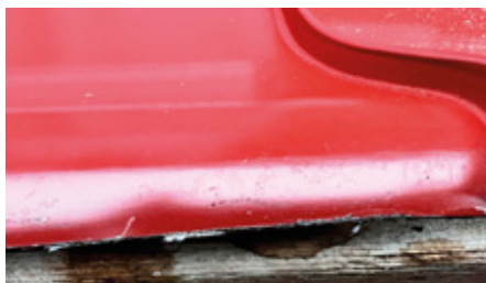
Krytina byla upravována úhlovou bruskou, což je hrubé porušení montážního návodu. Po řezání úhlovou bruskou je patrná začínající rez.
