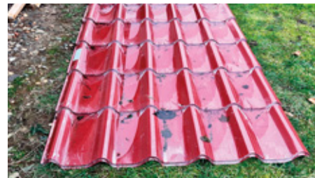
Zbývá uskladněná krytina není podložena a ve spádu - na tabuli stojí voda, která přes vlny nemůže odtékat.
