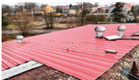
Místy je zcela nepochopitelně pod novou krytinou podložena i nová DHV (v tomto případě úplně zbytečně).
