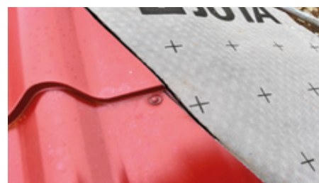
Nároží bylo řezáno úhlovou bruskou (zakázáno) a došlo i k proříznutí DHV. Patrně jsou spony zabezpečeny na střešní krytině, které jsou pokryté rzi.
