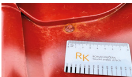
Zhotovitel při šroubování farmářských šroubů neometl kovové piliny, důsledkem je začínající rez.
