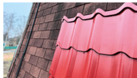
Není dodržen předepsaný podklad pod krytinu, navíc šrouby v původním bednění moc nedrží.
