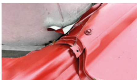
Velice neobdobné provedení střešní krytiny v místech detailů.
